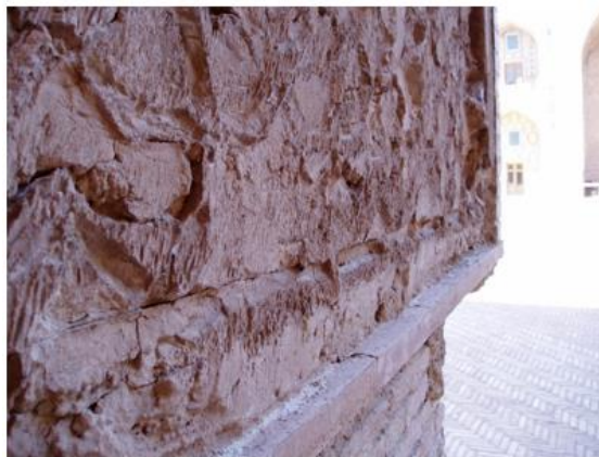
تصویر ۴: نمونه آسیب دیدگی دیواره شمالی ایوان جنوب غربی مدرسه غیائیه خرگرد. مأخذ: (نگارندگان، ۱۳۹۸)
